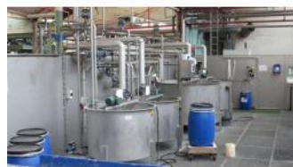
Referencia: MIC-031 COCINA DE PREPARACION 4 depositos Año: 2008 Marca: . Ancho mesa: .
