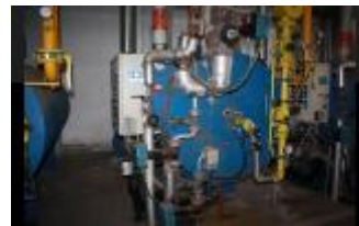
Referencia: LUI-050 Caldera de Vapor Año: 1998 Marca: Babcock Wanson Ancho mesa: -
