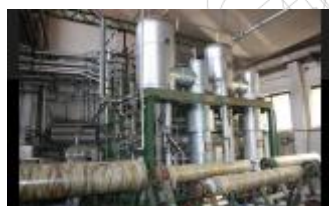
Referencia: LUI-037 Enfriador - Recuperador de Sos... Año: 1987 Marca: Kasag Ancho mesa: -
