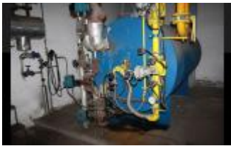
Referencia: LUI-049 Caldera de Vapor Año: 2000 Marca: Babcock Wanson Ancho mesa: -
