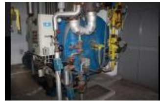
Referencia: LUI-052 Caldera de Vapor Año: 1998 Marca: Babcock Wanson Ancho mesa: -
