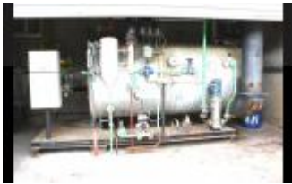
Referencia: EST-38 Caldera de vapor Año: 1989 Marca: Korwy Ancho mesa: .
