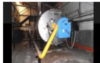
Referencia: TIG-01 GENERADOR DE VAPOR Año: 2000 Marca: Steambloc Ancho mesa: .
