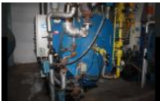
Referencia: LUI-051 Caldera de Vapor Año: 1998 Marca: Babcock Wanson Ancho mesa: -
