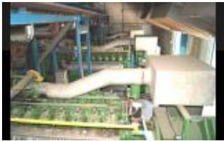
Referencia: M-1458 Cogeneración de corriente de ... Año: 1997 Marca: Jenbacher Ancho mesa: .
