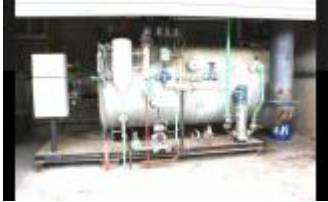
Referencia: EST-38 Caldera de vapor Año: 1989 Marca: Korwy Ancho mesa: .
