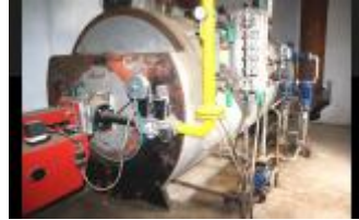
Referencia: EST-39 Caldera de vapor Año: 1992 Marca: Korwy Ancho mesa: .
