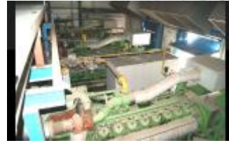
Referencia: M-1457 Cogeneración de corriente de ... Año: 1997 Marca: Jenbacher Ancho mesa: .
